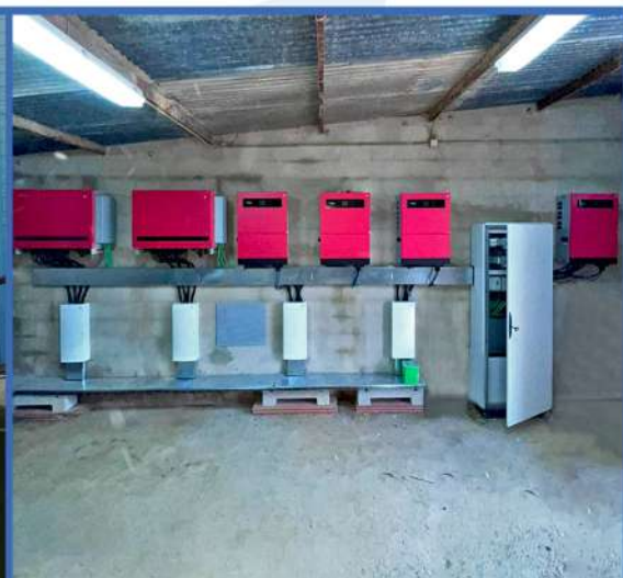
Instalación 6 Inversores Goodwe 2 de 100 KW, 4 de 50 KW
