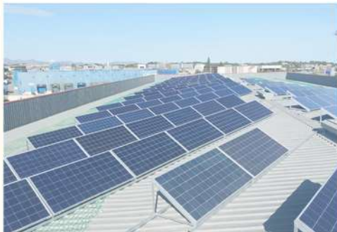
Instalación de autoconsumo fotovoltaico con venta de excedente que acaba de iniciar su funcionamiento en Paterna
