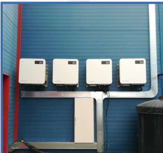
Instalación 4 inversores SMA 100 KW
